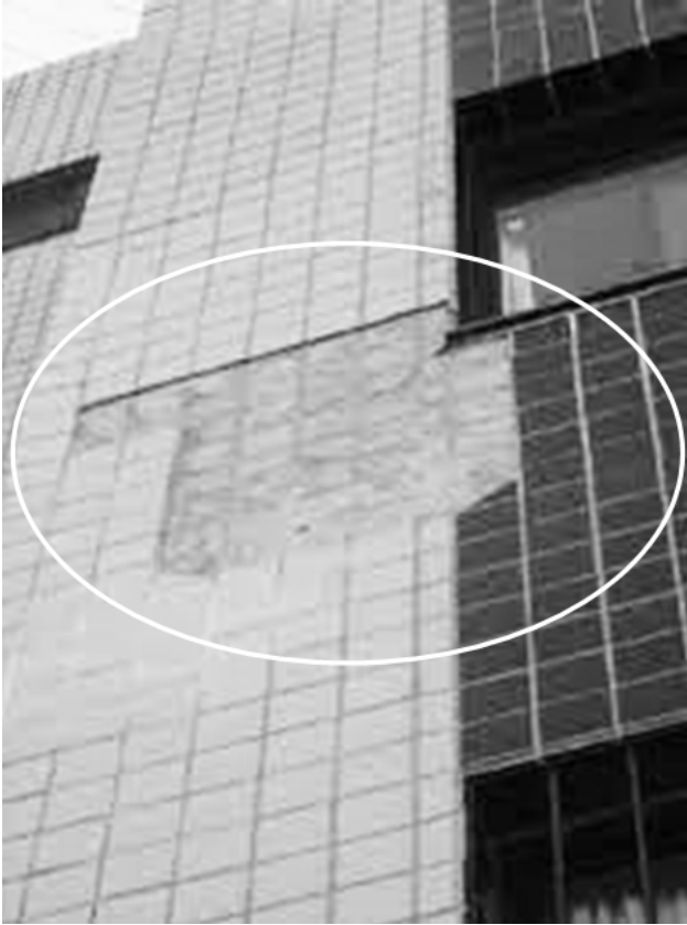
Figura 1 – Deslocamento de revestimento em paredes. Fonte: Arquivo da banca examinadora (2022).
