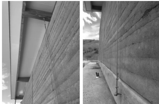
Ancoragem superior e inferior da estrutura da cobertura independente da taipa de pilão. Casa Cunha, Piracicaba (SP), 2018. Projeto: Estúdio Pilotis (Crédito: acervo Taipal) (Heise; Minto: 2022).
