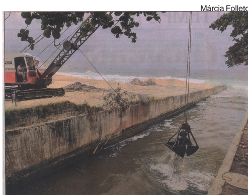
O EXCESSO de sedimentos no Canal da Visconde de Albuquerque aumenta o risco de alagamentos na área
